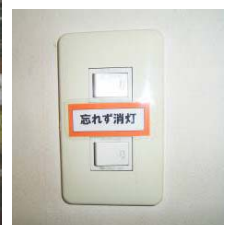
□節電ラベルの設置
